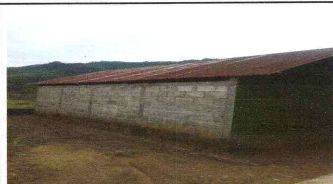
Foto 10: Se evidencia las láminas en mal estado.
