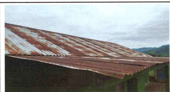
Foto 9: Se evidencia las láminas en mal estado.
