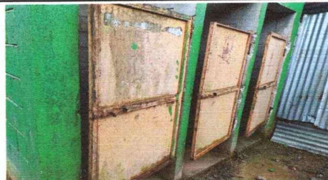
Foto 2: Sustitución de puertas de los baños en mal estado.
